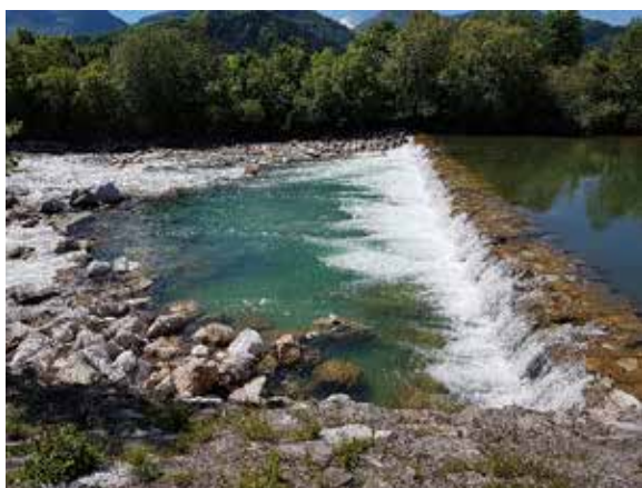
Slika 1: Pogled na poškodovano drčo iz levega brega
