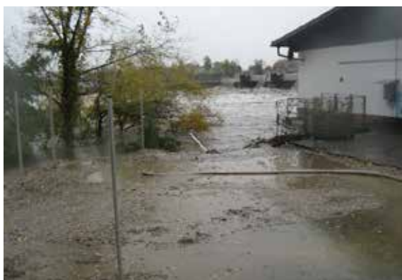
Slika 7: Črpališče Melje ob visokih vodah notranjost po novembra 2012
