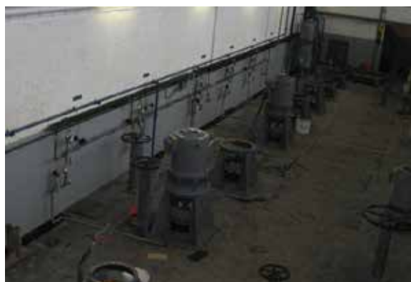
Slika 8: Notranjost črpališča Melje po poplavi
