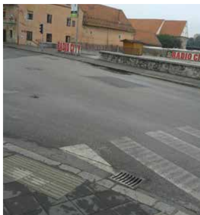
Sliki 36 – 37: Požiralniki na Koroški cesti ob tržnici
