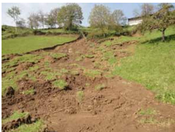
Slika 5: Zemeljski plaz na kmetijskem zemljišču (občina Sevnica).
