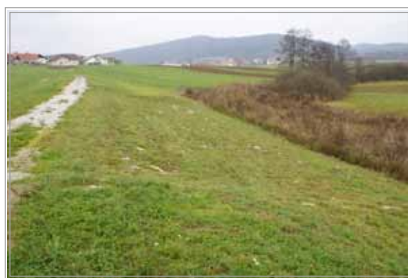
Slika 13: Primer neustrežno zasnovanega visokovodnega preлива čez nasuto pregrado brez ustrezno zasnovanega disipacijskega objekta in urejene odvodnje prelivne vode pod pregrado.
