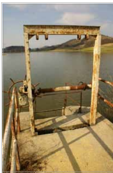
Slika 14: Nefunkcionalni dvizni mehanizem talne tablaste zapornice, ki jo nadomeščajo fiksne prekladne zapornice s fino lovilno rešetko za ribe
