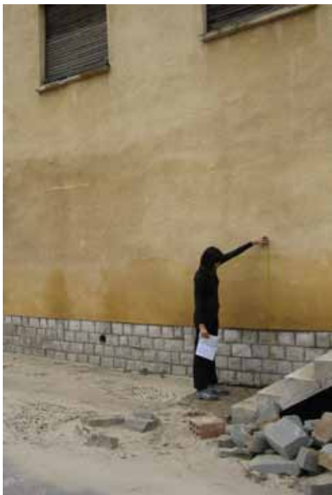
Slika 20: Višina poplavljenе hiše - Gostilna Cah v Rižani (Rižana 22). Višina vode je bila ca 160 cm.
