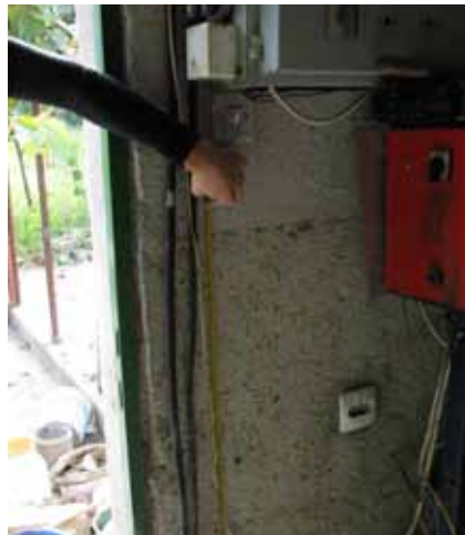
Slika 17: Izmerjena višina vode (117 cm) poplavljenega objekta pri bazenih ribogojnice Cunja
