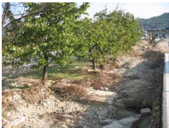
Slika 10: Poškodovana cesta pri mejnem prehodu Dragonja je bila že sanirana, sledovi so bili vidni le še ob cesti
