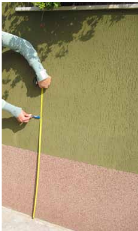
Slika 15: Višina vode (ca 83 cm) na hiši pri ribogojnici Prodan – Bezovica 30E
