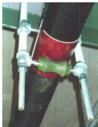
Slika 10. Detalj klizača za cevovod ispod mosta.
