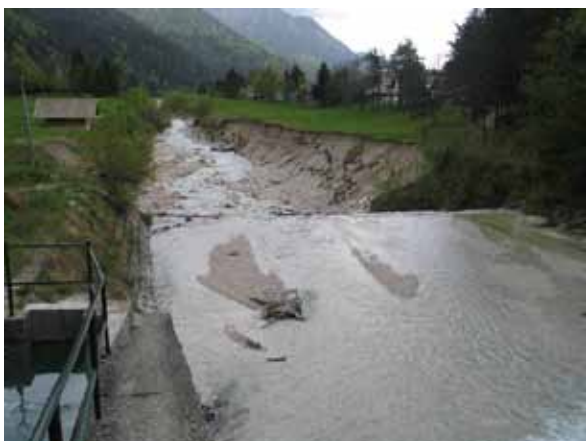
Slika 11: Erodირana desna brežina dolvodno od žel. mosta v Kranjski gori, julij 2005
