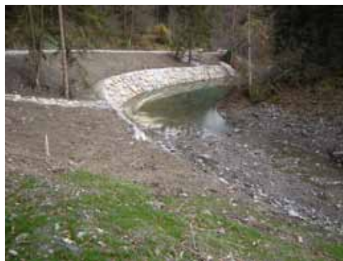
Oktober 2008: sanirana levoobrežna zajeda, ustaljena struga z ustalitveno zaplavnim pragom, ki umirja hudourni vodo (pogled dolvodno)
