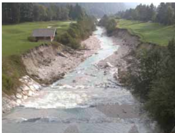
Slika 12: Erodირani obe brežini dolvodno od železnškega mosta v Kranjski gori, september 2009
