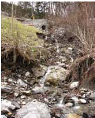
Oktober 2007: razdejana struga dolvodno od prepusta, sproščanje plavin
