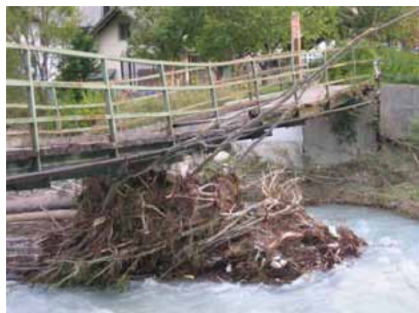
Slika 8: Naplavljen material, ki je povzročil poškodbo brvi, septembra 2009 (avtor: Ljiljana Smiljić), 11.9.2009
