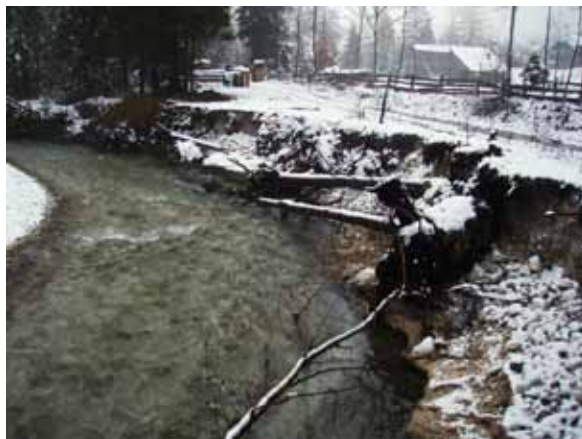
Slika 10: Erodირana desna brežina na območju G. Martuljka, november 2009
