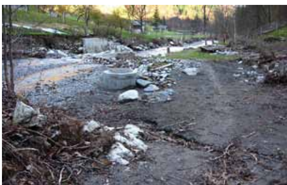
September 2007: popolnoma razdejana struga, odnešen ustalitveni prag in prečkanje kanalizacije, uničeno obrežno zavarovanje
