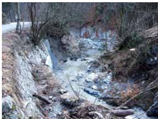
November 2007: spodkopani podporni zidovi reg. ceste, močno poglabljena struga, desno pobočje plazi v strugo (pogled dolvodno)
