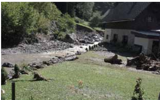
September 2007: erodirane brežine, poplavljen hiša, usad na desni brežini
