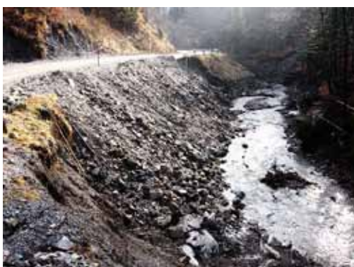
Oktober 2007: velika zajeda v cesto, močno poglobljena struga (pogled dolvodno)
