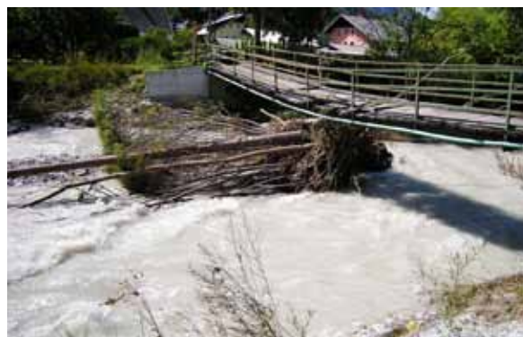
Sava Dolinka – močno poškodovan most za pešce v Gozd Martuljku
