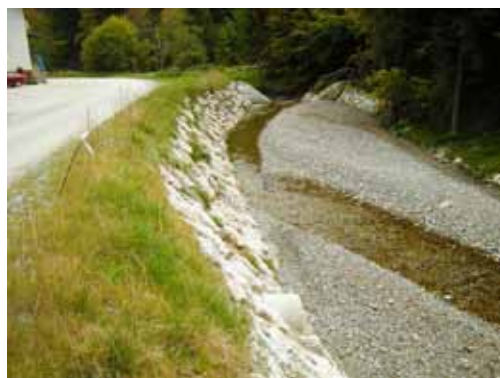
Oktober 2009: sanirana leva brežina, zaplavno ustalitvena pregrada na dolvodnem koncu (pogled dolvodno)
