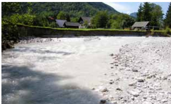
Sava Dolinka - velika zajeda (razgaljena kanalizacijska cev) v Gozd Martuljku
