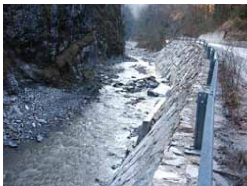
November 2007: spodkopani podporni zidovi reg. ceste, odsek struge zelo primeren za zaplavno pregrado
