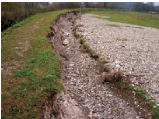
Poškodba vv nasipa v Nazarjah (zračna stran)
