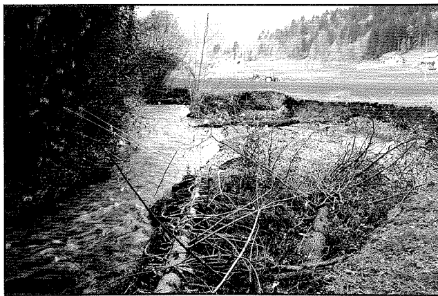
Jablaniški potok pod Gradiškimi Lazami; 75 m dolga poškodba desnega brega, nastala novembra 1998
