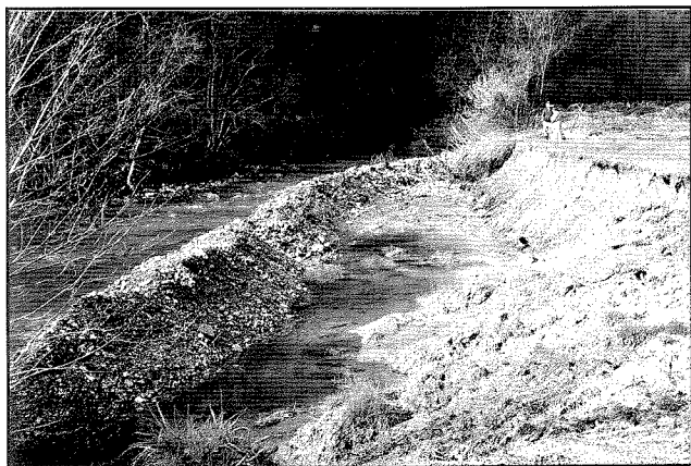
Novembra 1998 erodirani levi breg Gradaščice pod Srednjo vasjo pred Polhovim Gradcem
